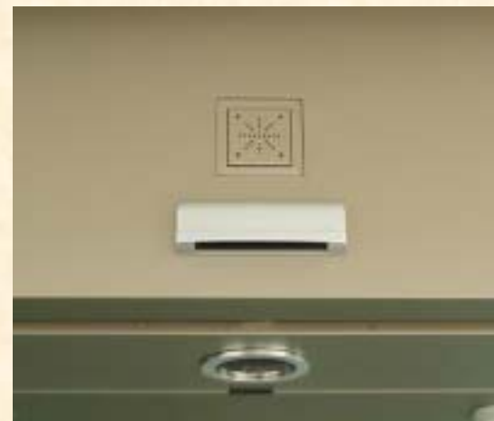
施設出入口 (スピーカ埋込)
