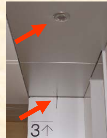
天井埋込スピーカと 受信用アンテナ
