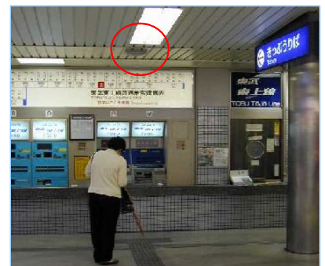
エコーチャイム 設置事例; 埼玉県 東武東上線志木駅 券売機
